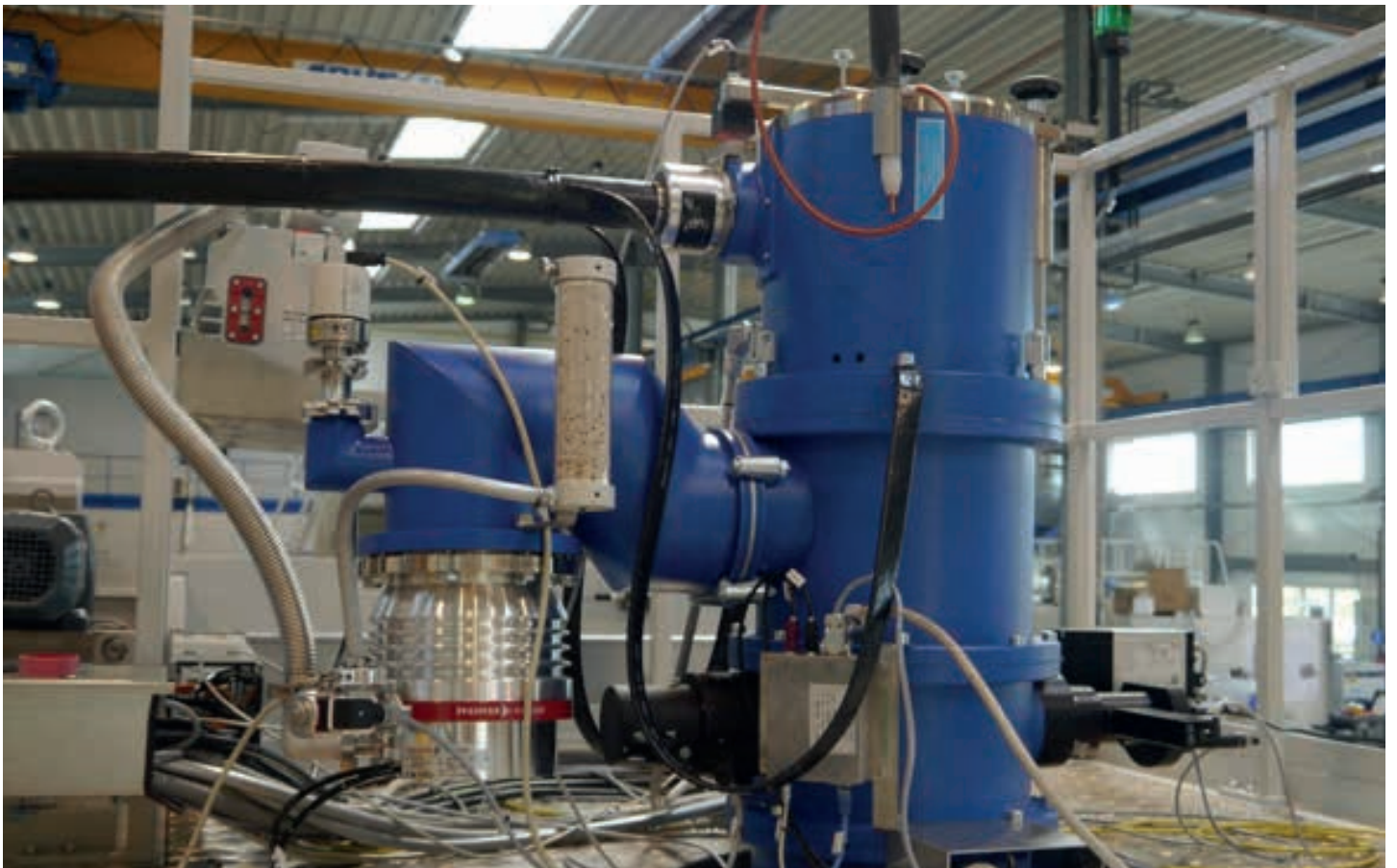
Abbildung 5: HiPace Turbomolekularpumpe Turbo am Elektronenstrahlgenerator Mit freundlicher Genehmigung von Steigerwald Strahltechnik
