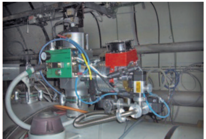
Erzeugung des Isolationsvakuums mit HiPace 300 Turbopumpen
