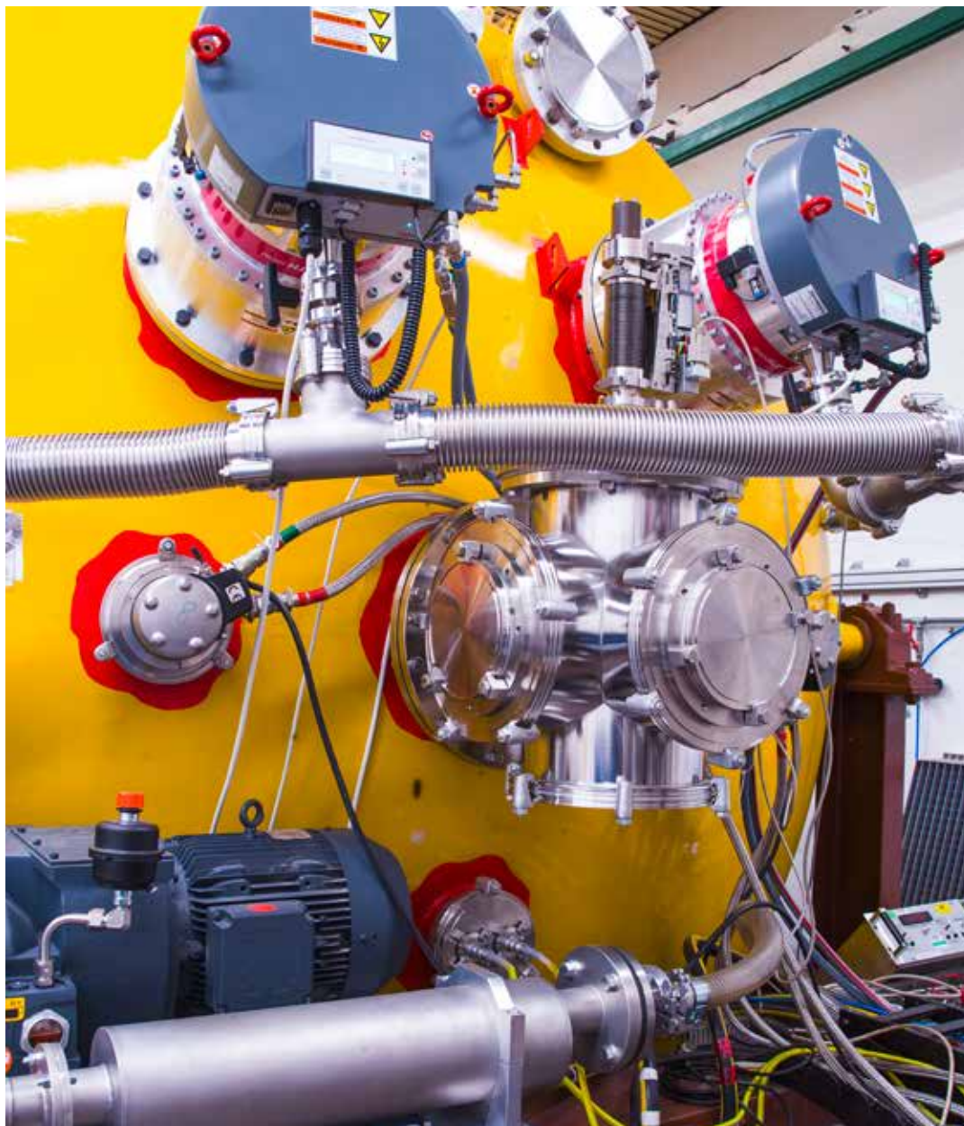
Abbildung 2: Zwei ATH 3204 M Turbopumpen mit Schraubpumpe HeptaDry 200 als Vorpumpe an der JUMBO-Weltraum- simulationsanlage zum Testen von Ionentrieb- werken. Zusammen mit zwei HiPace 2300 mit Duo 65 Vorpumpen sowie acht Kryopumpen kommt man auf ein Pumpvermögen von 150.000 Litern Xe pro Sekunde.
